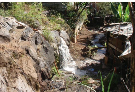
Lançamento de esgoto e deposição inadequada de lixo são recorrentes no Taquaril [acima] e no Acaba Mundo [abaixo]
