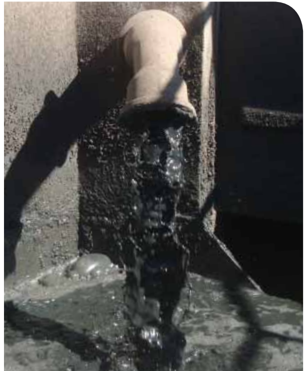
A Caixa de Distribuição de Vazão encaminha o esgoto para o processo de tratamento biológico que acontece nos reatores anaeróbios.
